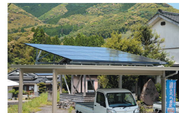
カーポートの屋根に設置された太陽光発電パネル
