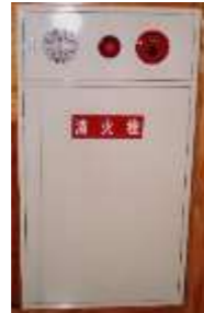
おくないしょうかせん 屋内消火栓
