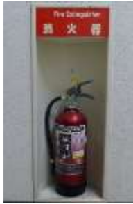
しょうかき 消火器
