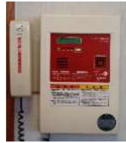
かさいつうほうそうち 火災通報装置
