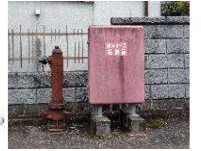
ちじょうしきしょうかせん 地上式消火栓
