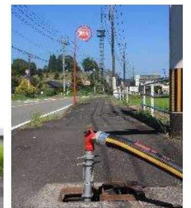
ちかきしょうかせん 地下式消火栓
