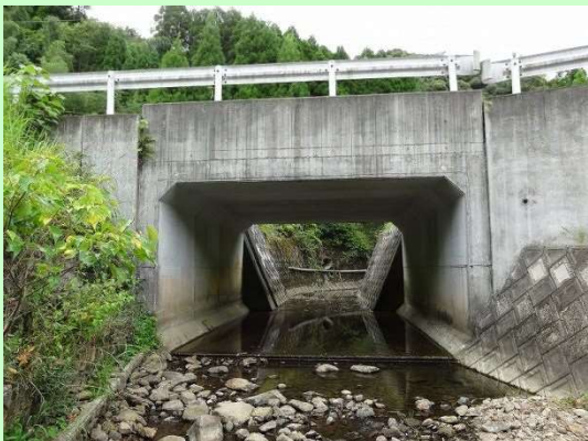
橋梁名: 大山口 2 号橋 橋種: コンクリート橋(RC BOX) 架設年: 2004(H16)
