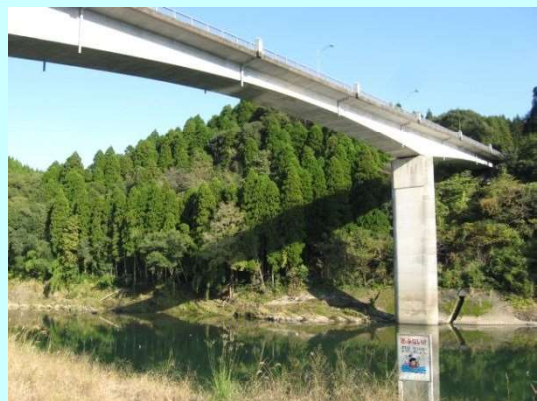
橋梁名: 鴛鴦橋 橋種: コンクリート橋(PC ポス텐箱桁橋) 架設年: 1986(S61)
