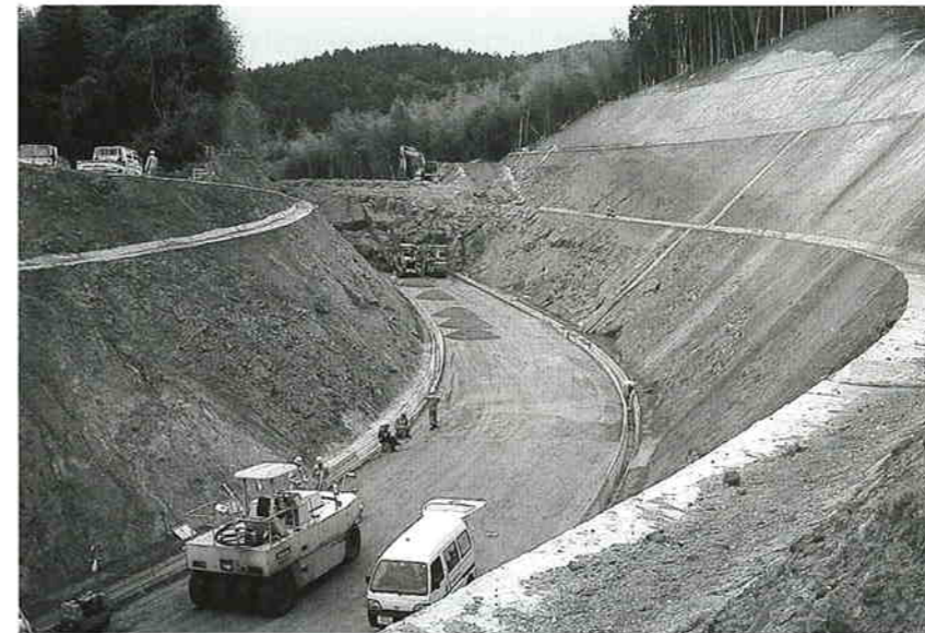
広域営農団地農道等整備事業(川薩3期地区)で工事が進められる大平地区(本年度も負担金約29,000千円計上)
