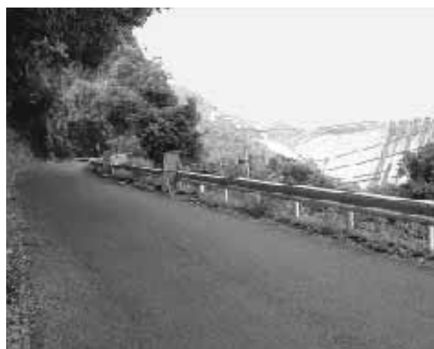
幅員も狭く災害のたびに通行止めとなる町道平江線
