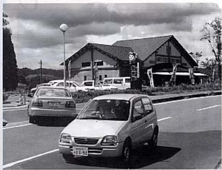
村づくり整備事業で進入路の拡幅工事が行われる自慢館
