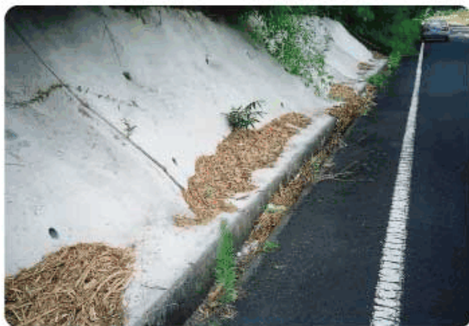
落ち葉等が詰まった道路側溝
