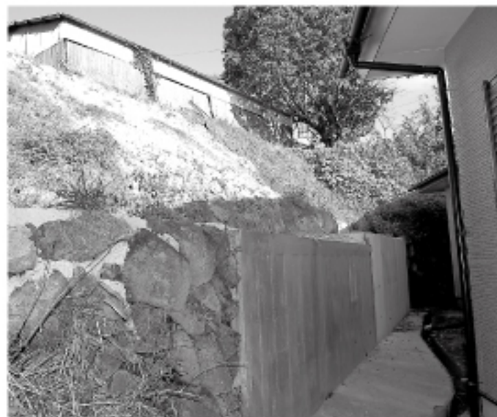
宅地の土砂崩れによる災害復旧現場（求名地区）
