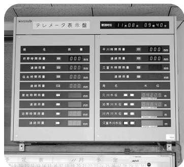
役場本庁に設置されている 雨量・水位等の表示板
