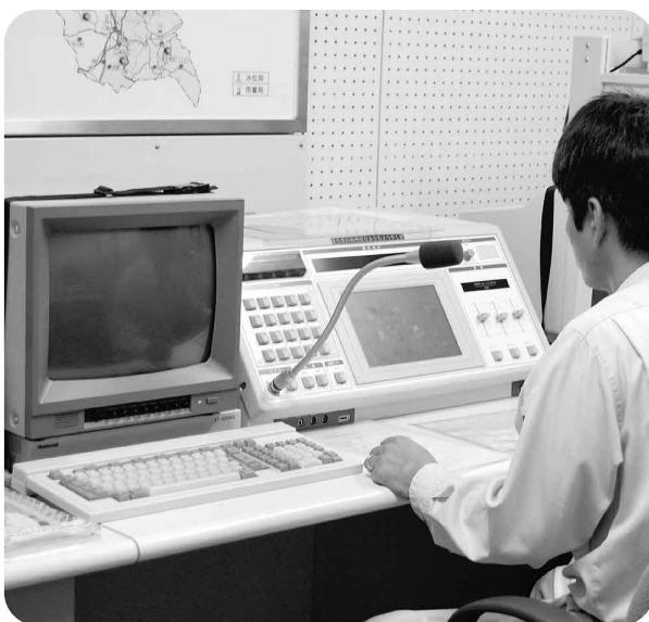
役場本庁の防災行政無線放送施設
