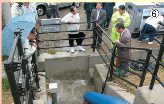
⑥ 災害復興対策調査特別委員会による排水用水中ポンプの試験運転調査
