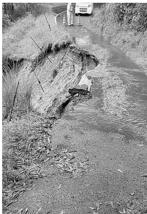
被災した神子栗野地区の町道へゴ山線
