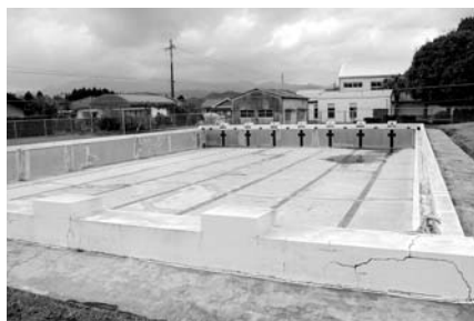
経年劣化が激しい鶴田中学校のプール
