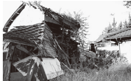
老朽化で屋根が落ちてしまった廃屋
