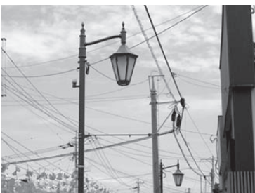
電源立地交付金事業により整備された虎居区の街路灯
