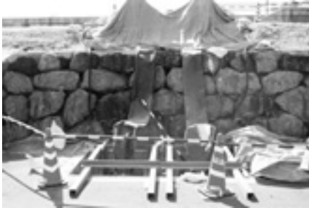
内水排水ポンプの設置状況(虎居区)
