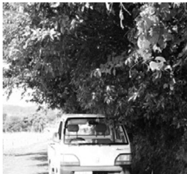
通行に支障を来している法面の支障木
