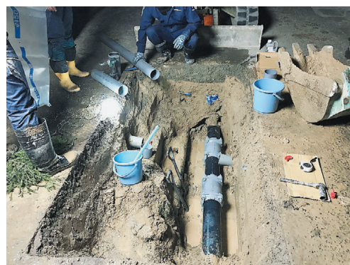
漏水箇所の工事現場
