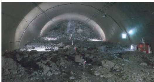
崩落した北薩トンネル内部（写真は県提供）
