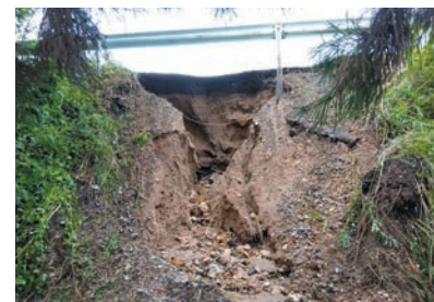
大雨による被害状況
