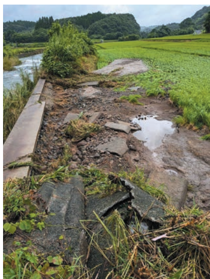
大雨による被害状況（中津川区）
