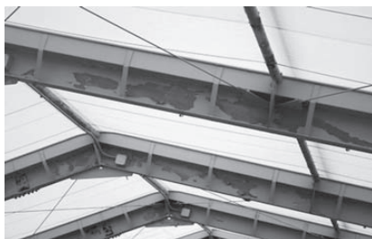
プール上屋鉄骨の塗装の剥離状況
