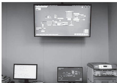
整備された中央監視システム（水道課）
