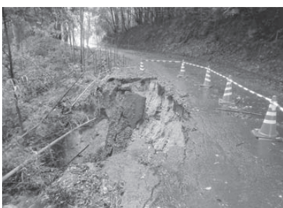
梅雨前線豪雨で被害のあった町道築平中央線
