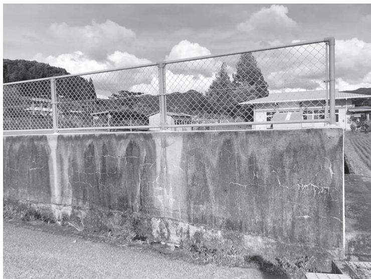
ひび割れて危険なブロック塀
