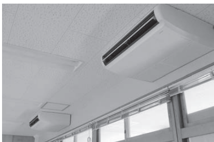
宮之城中学校に設置済みの空調設備
