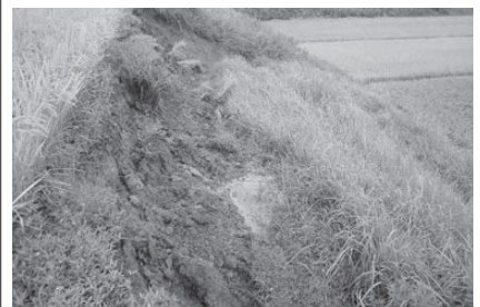
集中豪雨による水田の被災状況
