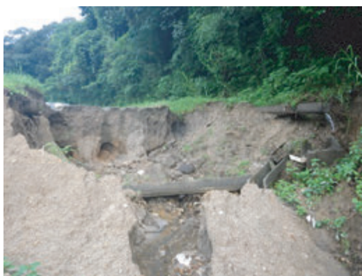
豪雨による水路の崩壊
