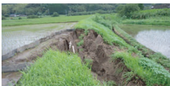
早期の復旧工事が期待される（水田法面崩壊）
