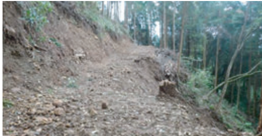
崩壊した林内作業道(永野地区)
