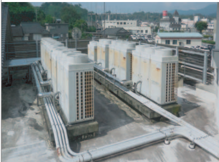
老朽化した空調設備（室外機）
