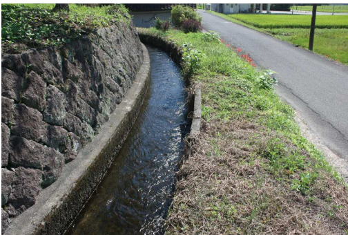
8 用水路が大雨時溢れ出て危険
