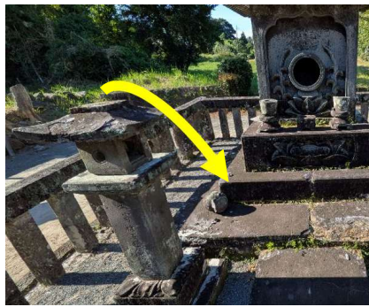
⑥T20_燈籠損傷状況
