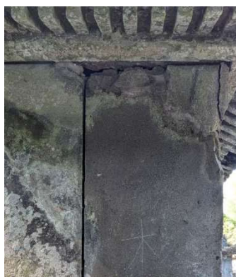
⑭B08_墓碑損傷狀況
