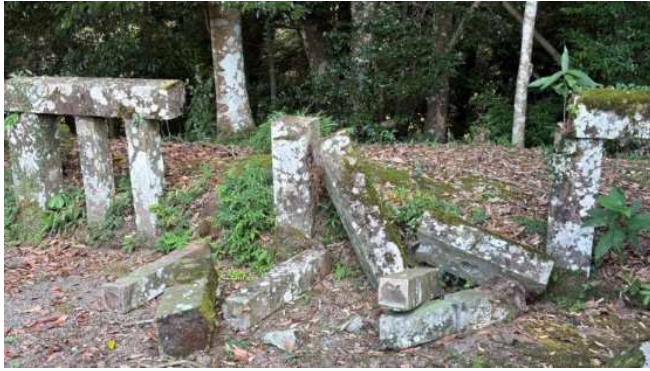
⑳玉垣損傷状況
