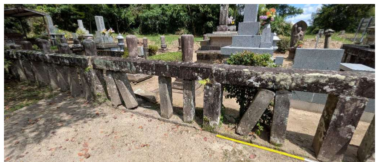
④墓所周囲の玉垣損傷状況
