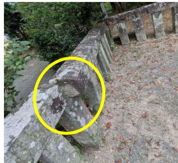
⑨墓所周囲の玉垣損傷状況
