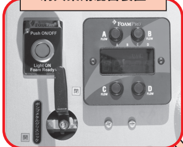
消火薬剤混合装置
