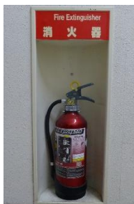
しょうかき 消火器
