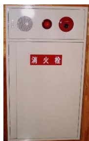
おくないしょうかせん 屋内消火栓
