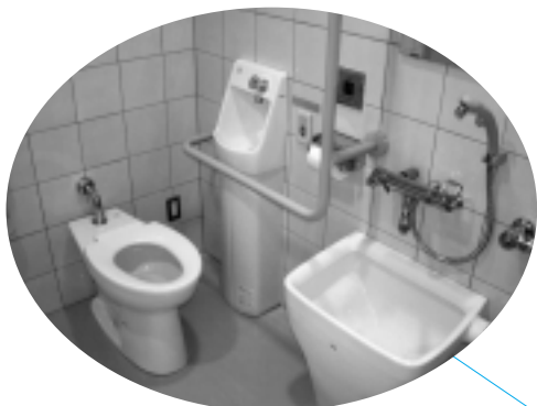
▲身障者用トイレ オストメイト（人工膀胱者用）機能を備えています
