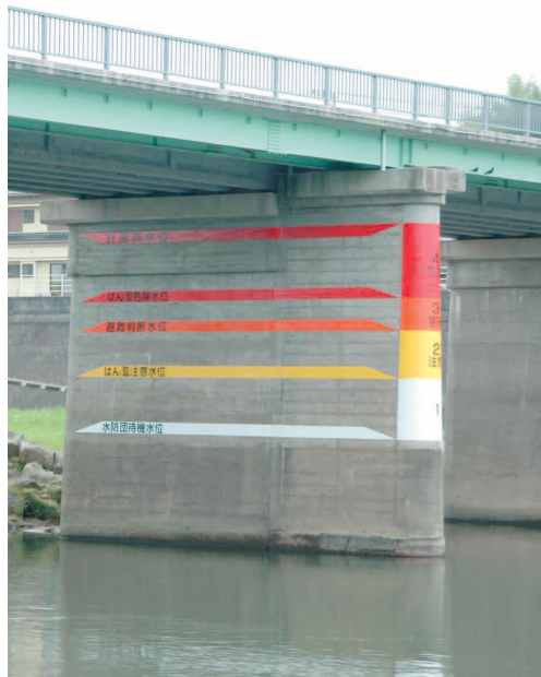
宮都大橋に表示された危険度レベル
