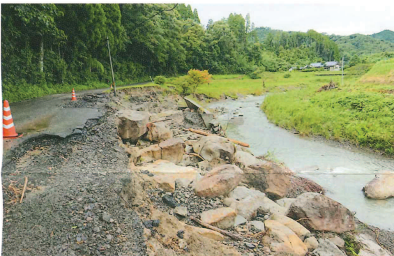
護岸が大きく削られた柳野川
