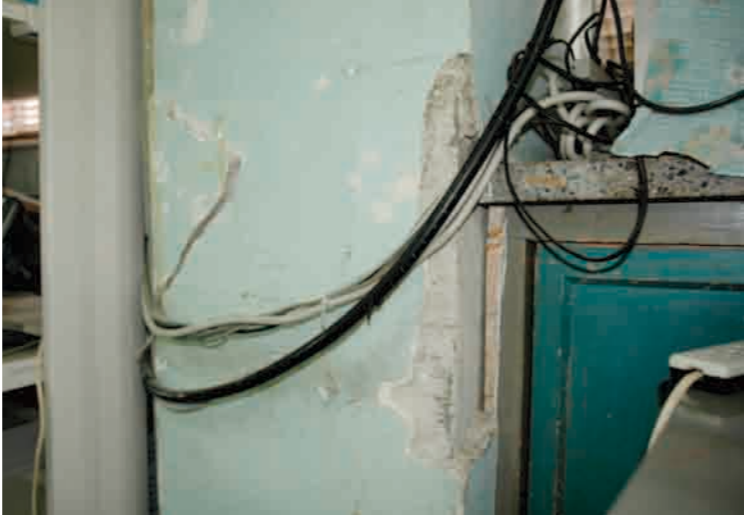
本館南庁舎2階（総務課）壁面のひび割れ
