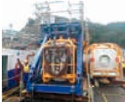
潜水設備 写真中央に写る設備は、S.D.C. といって潜水士が船上と作業水深の間を、作業水深と同じ気圧のまま昇降できる装置です。
