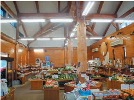
自慢館に取り付けられたLED照明
