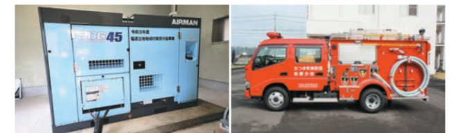
北原非常用発電機
