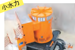
泊野川水力発電所
